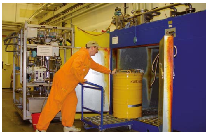
Abb. 39: Konditionierung von Abfällen (Fasstrochnungsanlage)
